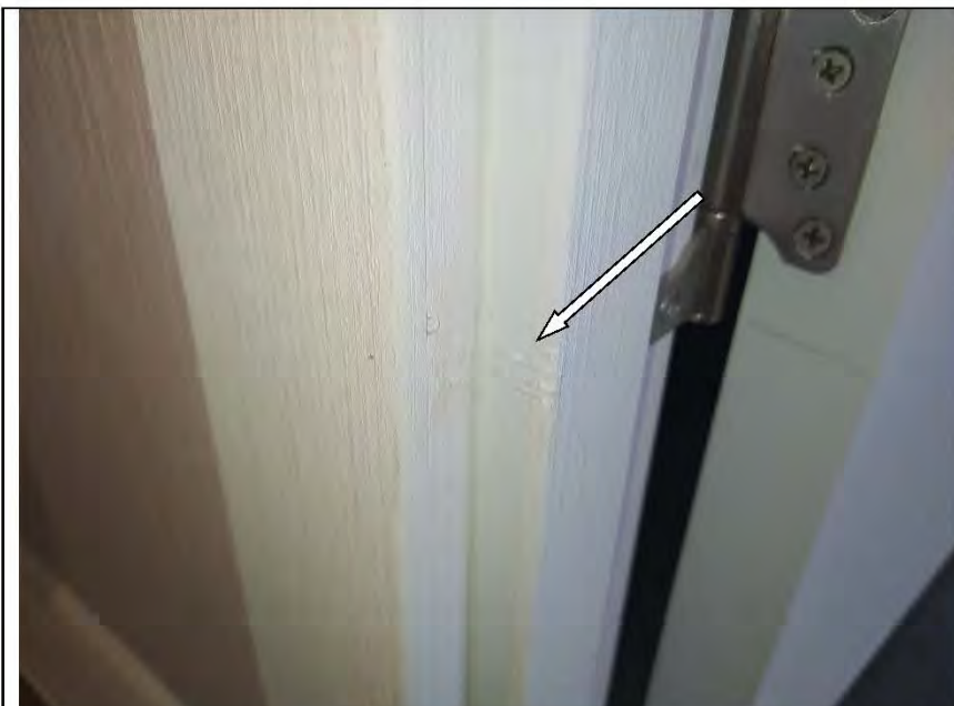
Фото №46. Коробка деревянного дверного блока в гостиной имеет дефекты (загрязнение малярными составами).
