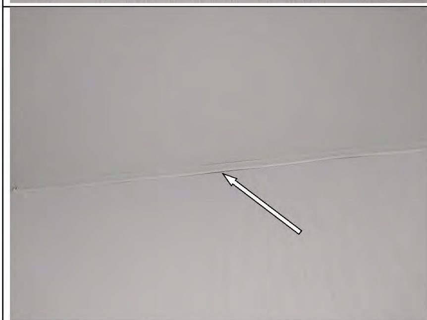
Фото №63. Дефект монтажа декоративного молдинга натяжного потолка в кухне.
