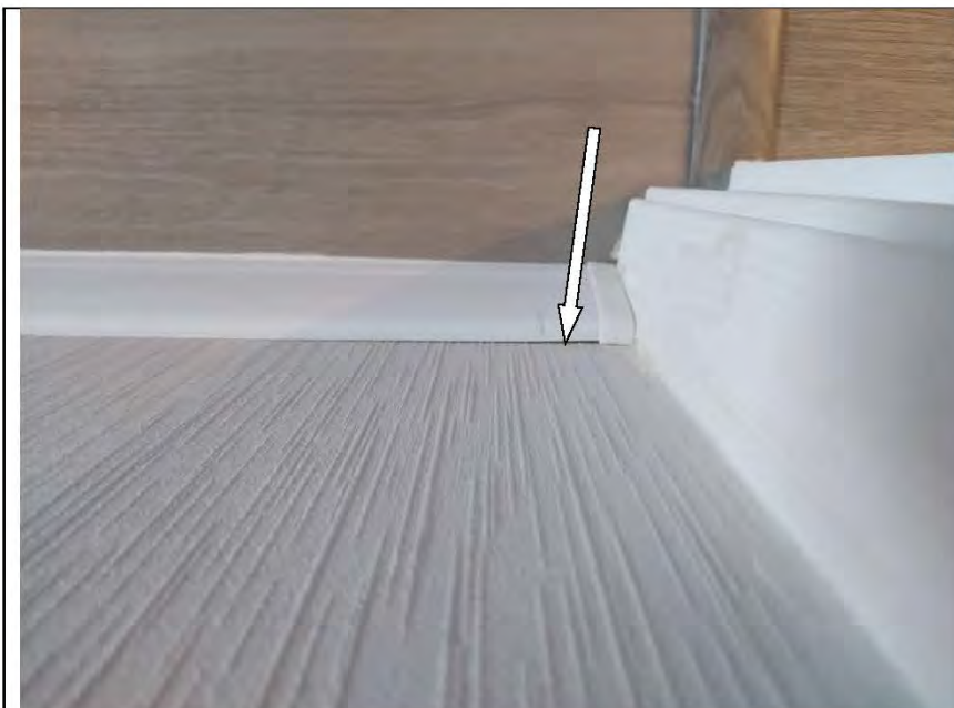
Фото №70. Напольный плинтус ПВХ неплотно прилегает к стене в кухне (отходит), образуется зазор.
