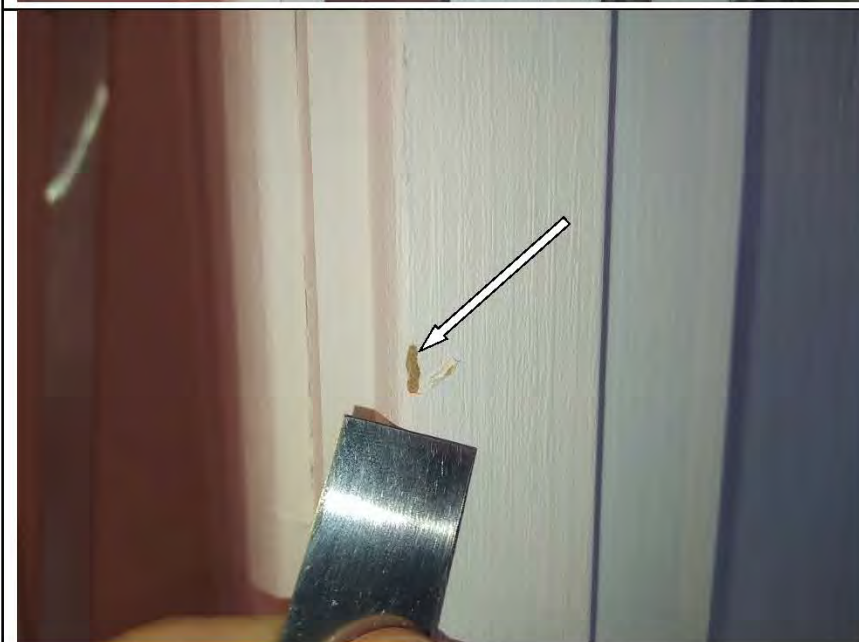
Фото №48. Коробка деревянного дверного блока в кухне имеет дефекты (скол).
