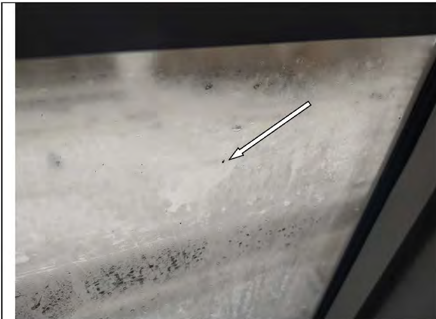
Фото №31. На стеклопакете оконного блока на балконе имеется дефект (окалины).
