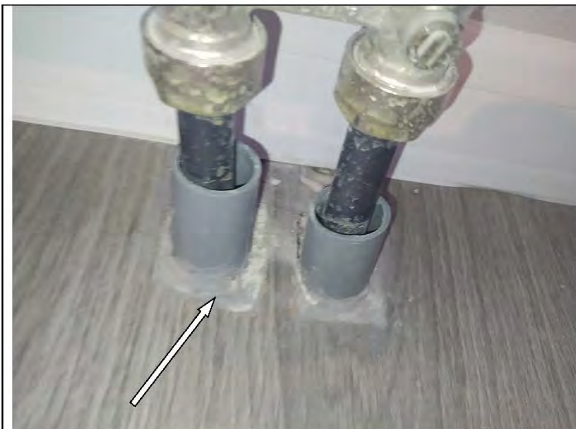
Фото №58. Дефект заделки отверстия для трубопровода отопления в напольном покрытии из ламината в спальне.
