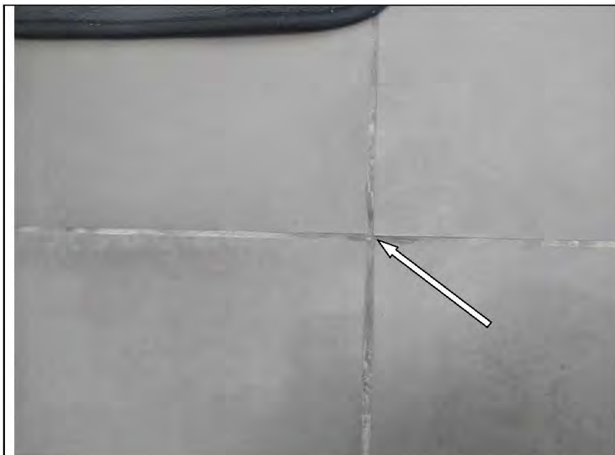
Фото №61. Затирка напольной плитки выполнена с нарушениями в ванной комнате (каверны).
