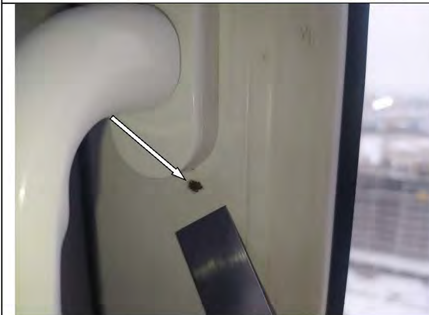
Фото №21. Профиль ПВХ оконного блока в гостиной имеет дефекты (стертость).
