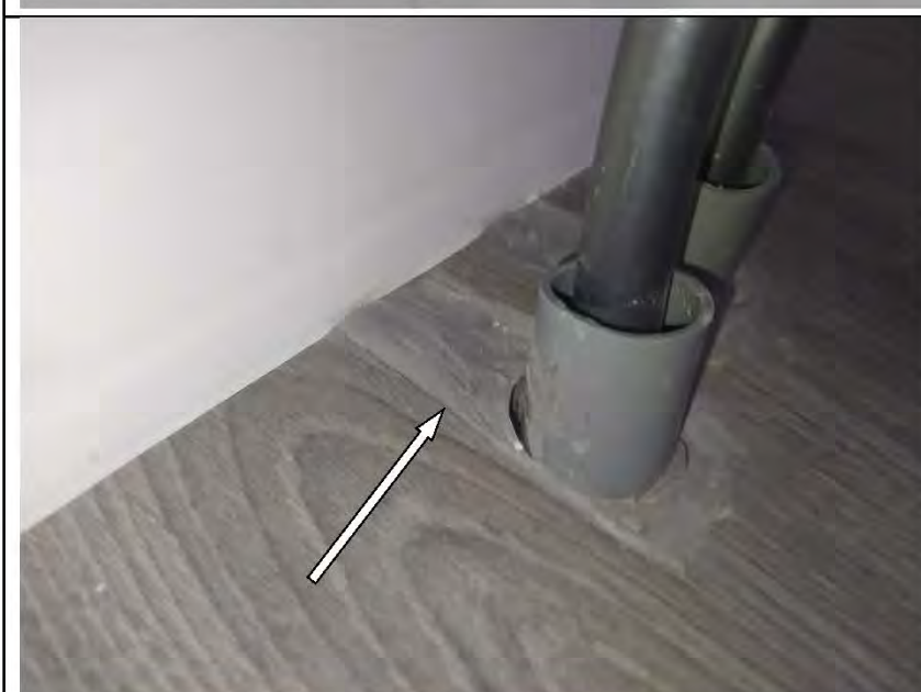
Фото №56. Дефект заделки отверстия для трубопровода отопления в напольном покрытии из ламината в гостиной.
