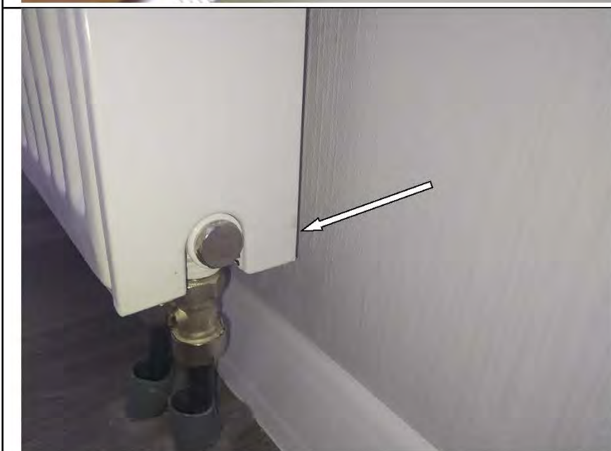
Фото №38. Отопительный прибор имеет дефект в покраски защитного кожуха в гостиной (загрязнение малярными составами).
