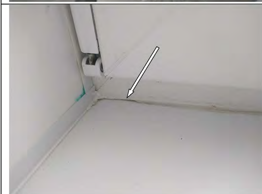
Фото №33. Дефект монтажа подоконной доски в гостиной (щель между оконным блоком и подоконной доской).
