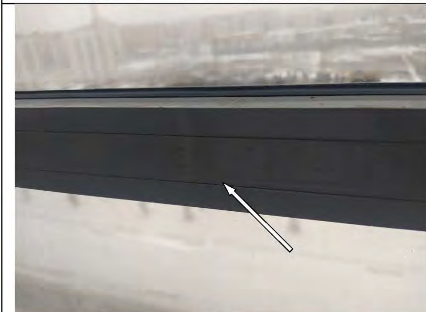
Фото №26. Дефект на металлическом профиле оконного блока на балконе (поверхностная коррозия).
