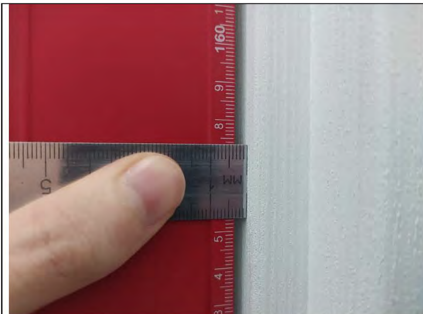
Фото №43. Отклонение коробки дверного блока в ванной комнате.
