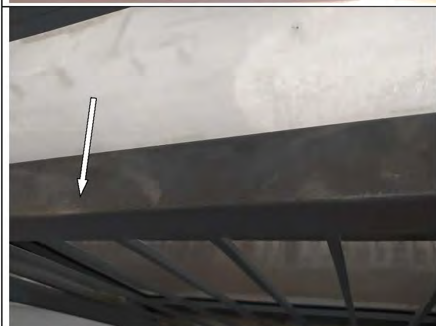
Фото №68. Дефект металлического профиля ограждения балкона (коррозия).
