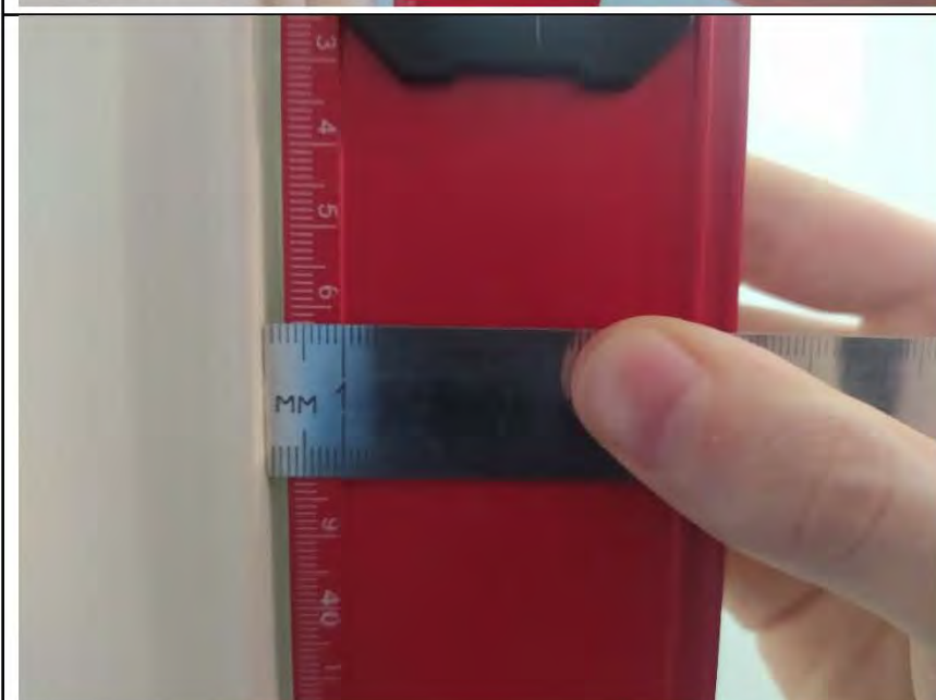
Фото №42. Отклонение коробки дверного блока в санузле.
