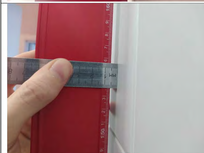
Фото №12. Измерения уровня стен в ванной комнате.
