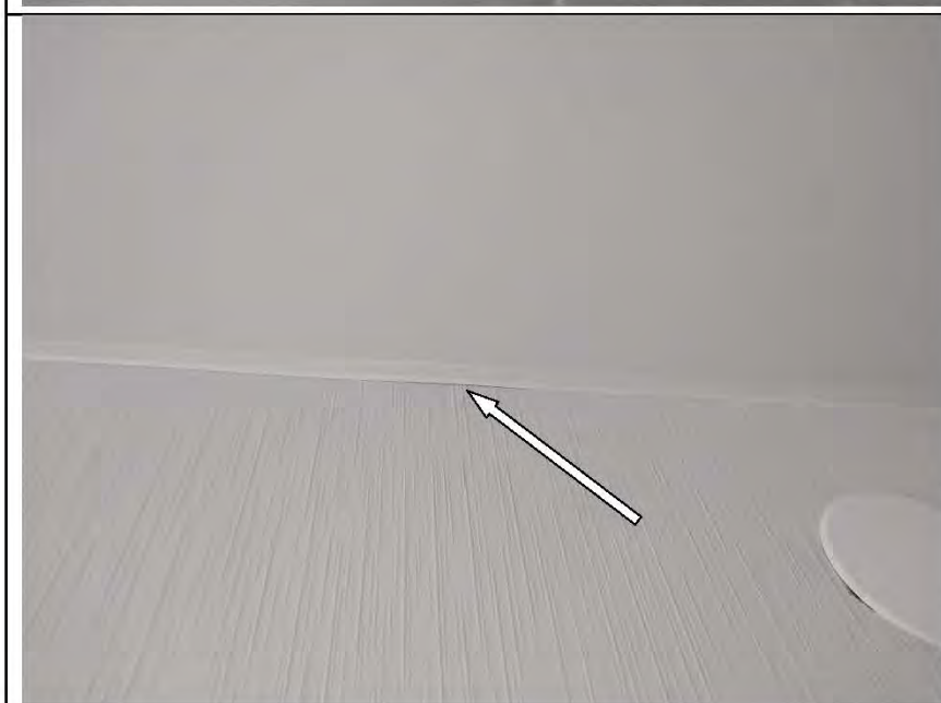
Фото №62. Дефект монтажа декоративного молдинга натяжного потолка в гостиной.
