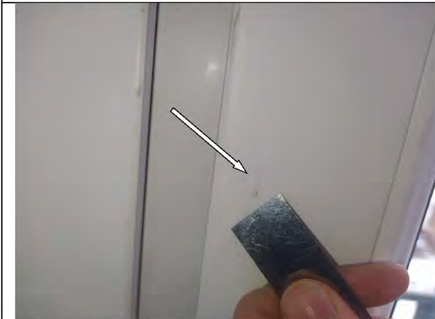
Фото №20. Профиль ПВХ оконного блока в гостиной имеет дефекты (царапина).
