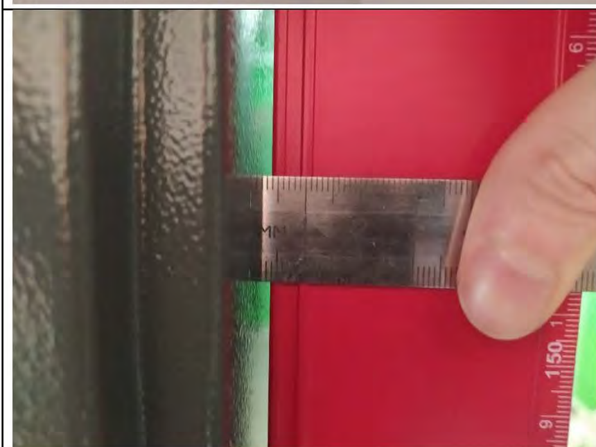
Фото №66. Отклонение коробки входного дверного блока.
