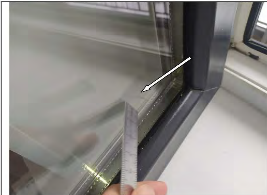
Фото №28. На стеклопакете оконного блока ПВХ в спальне имеется дефект (царапина).
