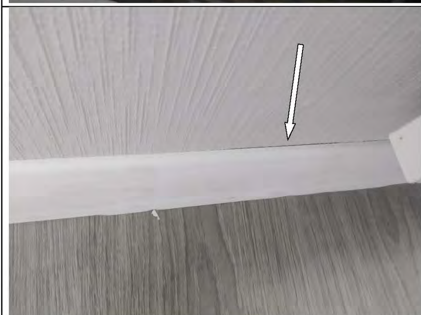
Фото №69. Напольный плинтус ПВХ неплотно прилегает к стене в гостиной (отходит), образуется зазор.
