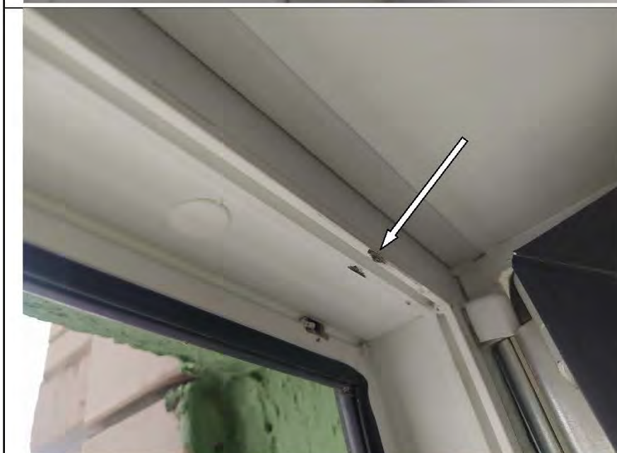
Фото №23. Профиль ПВХ оконного блока в кухне имеет дефекты (притертость).
