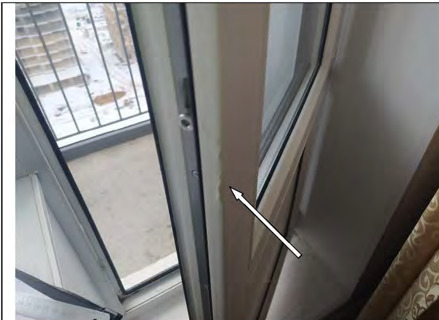
Фото №25. Профиль ПВХ дверного блока в спальне имеет дефекты (загрязнение малярными составами).
