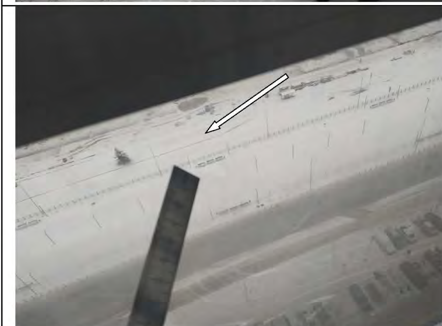
Фото №32. На стеклопакете оконного блока на балконе имеется дефект (царапина).
