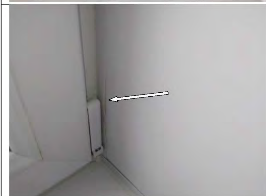
Фото №18. Отсутствие герметичности мест примыкания оконного блока и накладных откосов в гостиной.
