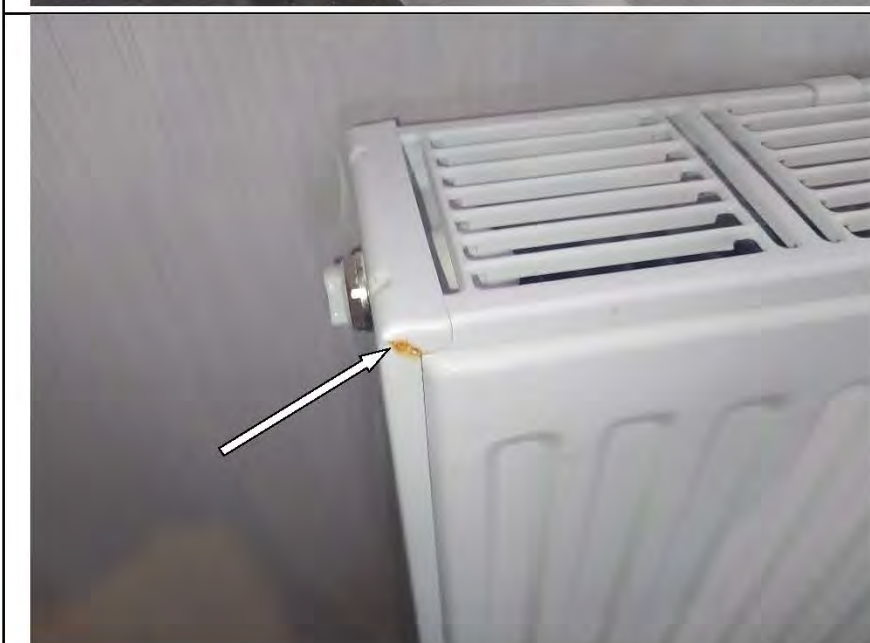
Фото №39. Кожух отопительного прибора в спальне имеет дефект поверхности (коррозия).
