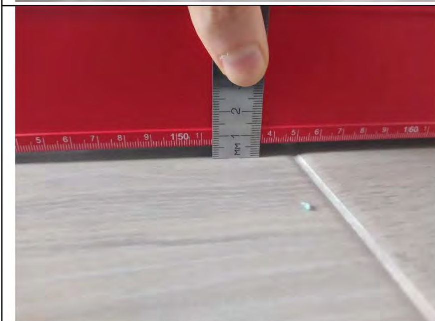
Фото №17. Измерения уровня напольного покрытия в кухне.
