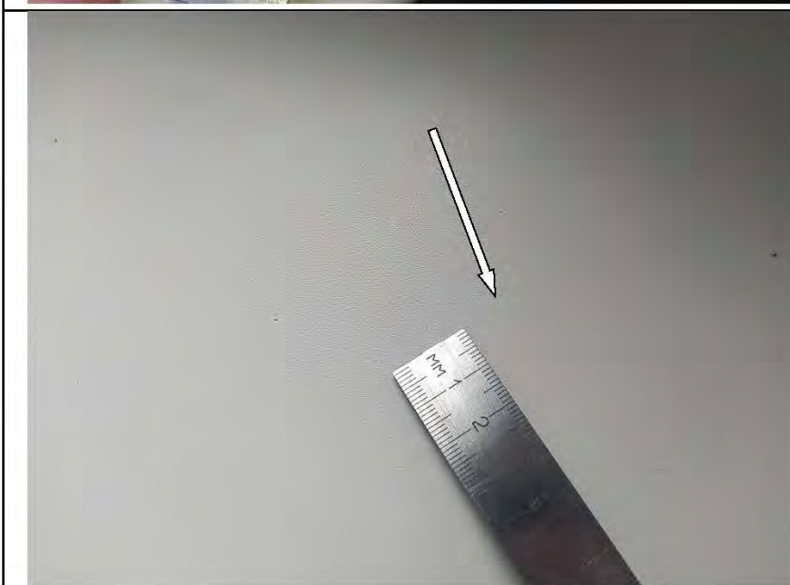
Фото №36. На лицевой поверхности подоконной доски в кухне имеются дефекты (царапины).
