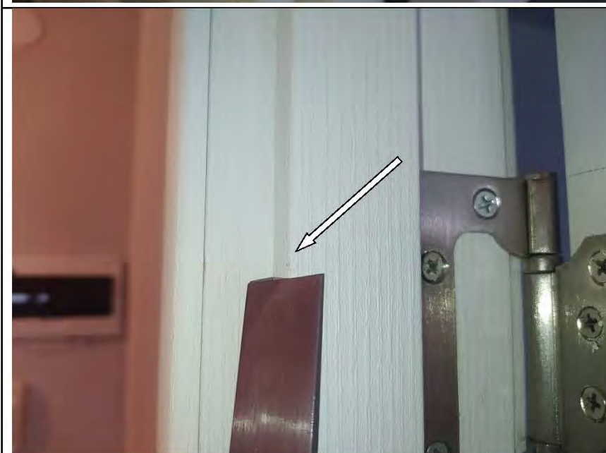
Фото №47. Коробка деревянного дверного блока в гостиной имеет дефекты (скол).
