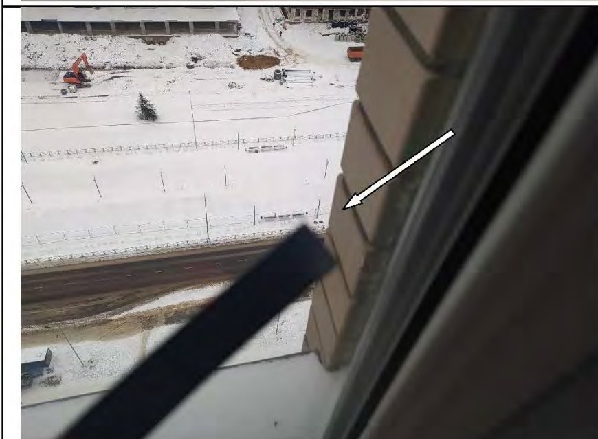
Фото №27. На стеклопакете оконного блока ПВХ в кухне имеется дефект (царапина).
