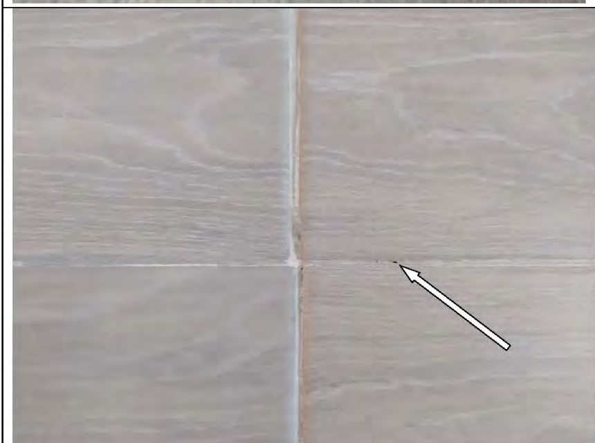
Фото №59. Затирка напольной плитки выполнена с нарушениями в кухне (каверны).
