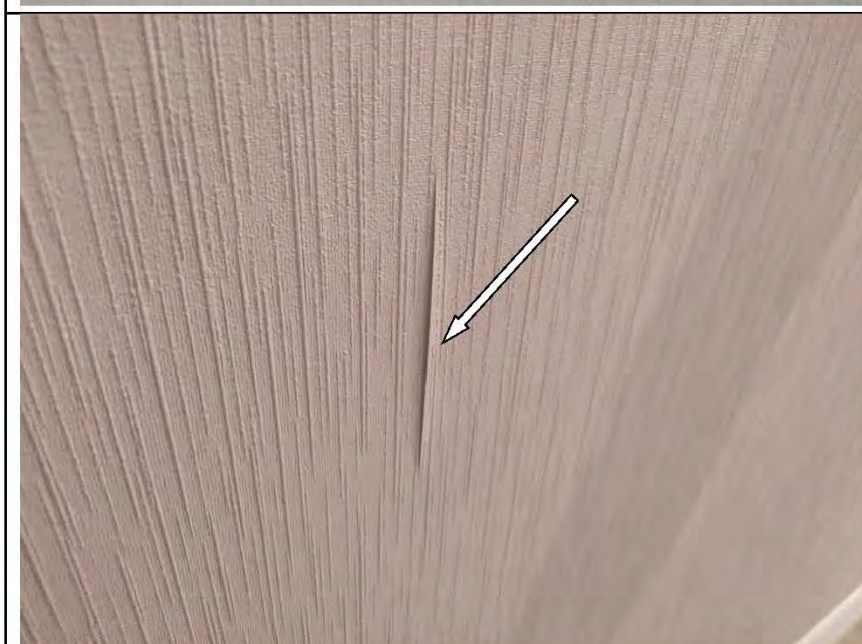
Фото №53. Дефект поклейки обоев в прихожей (отслоение).
