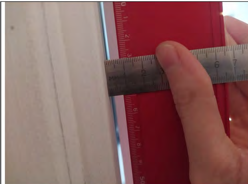
Фото №40. Отклонение коробки дверного блока в спальне.
