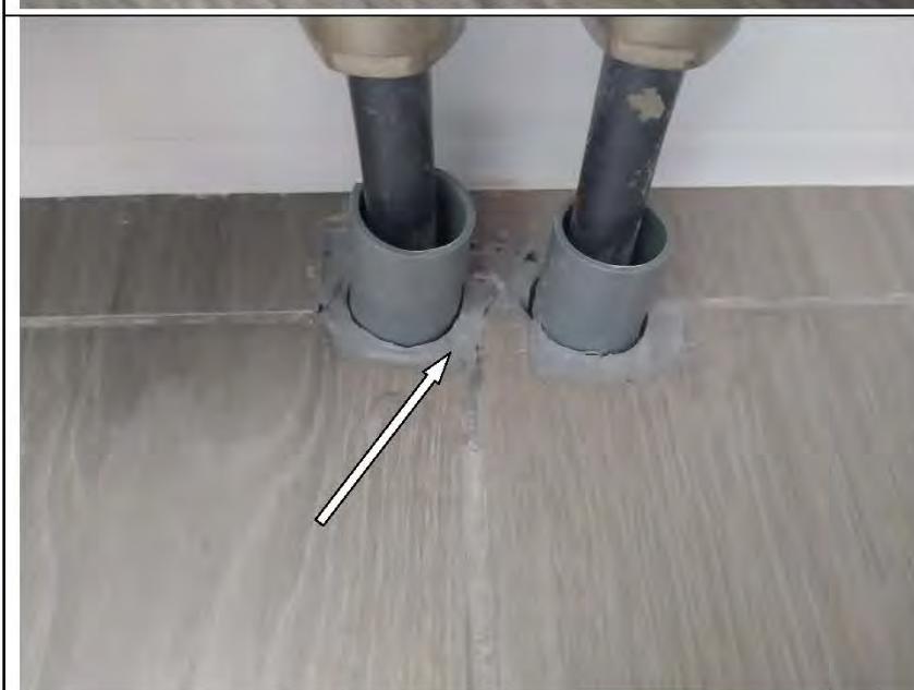
Фото №57. Дефект заделки отверстия для трубопровода отопления в напольном покрытии из керамической плитки в кухне.
